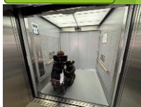
大型エレベーター
